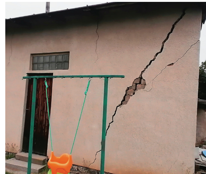
Obr. 5. a 6. Ukázka aktivních trhlin ve zdivu při sesednutí stavebního objektu, které se projevilo až po určitém čase.
