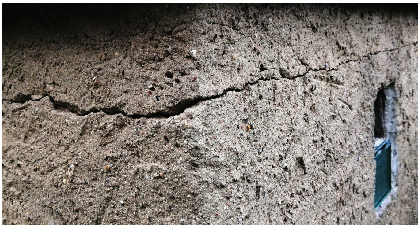
Obr. 1: Trhlina na atice ploché střechy.
