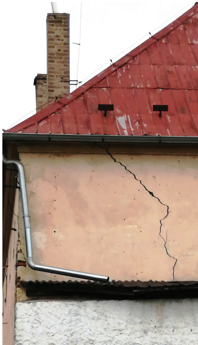
Obr. 2: Přístavba narušila základovou půdu a původní stavební objekt začal sesedat.
