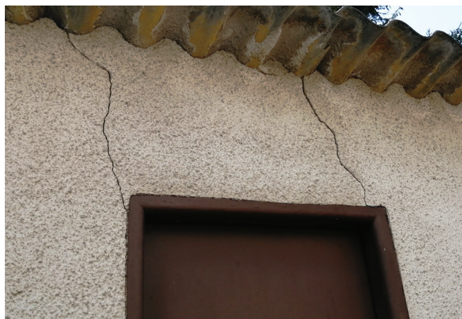
Obr. 6: Trhliny a praskliny na stavebním objektu s chybějícím ztužujícím pasem – železobetonovým pozedním věncem.
