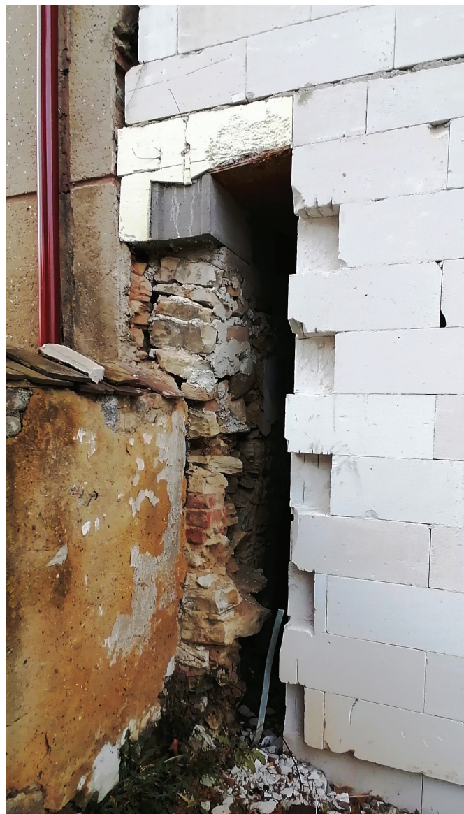
Obr. 4: Poruchy v místech napojení různých druhů zdicích materiálů (pálená cihla, kámen, pórobeton) a stavebních objektů
