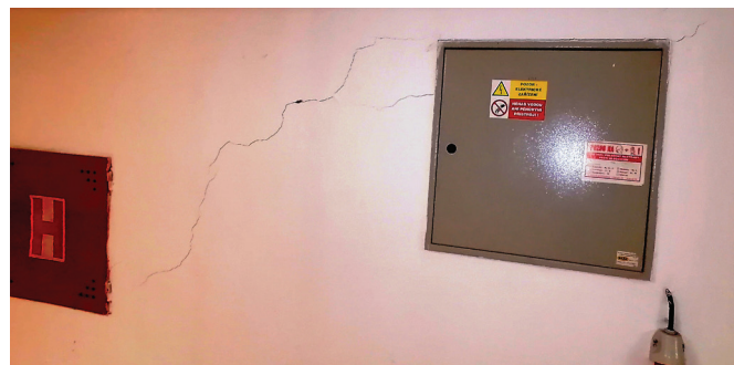
Obr. 5 – Trhliny v důsledku oslabení zdiva – vedení dodatečných instalací.
