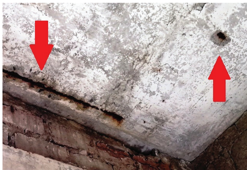
Obr. 5: Špatné uložení ocelové výztuže, její koroze, výztuž vyčnívající z vodorovné konstrukce.
