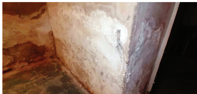
Obr. 2: Výkvěty solí na omítce stěn v suterénu způsobené vztlínající vlhkostí v důsledku nefunkční svislé a vodorovné hydroizolace pod zdivem stavebního objektu.
