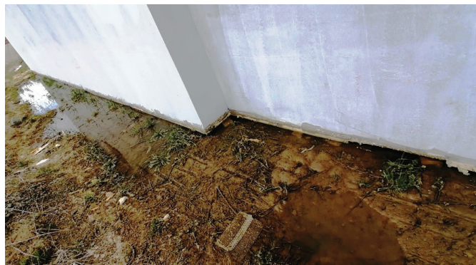
Obr. 3: Nedostatečné odvodnění stavebního objektu v oblasti s jílovou, těžce propustnou zeminou (voda se zadržuje i když neprší).
