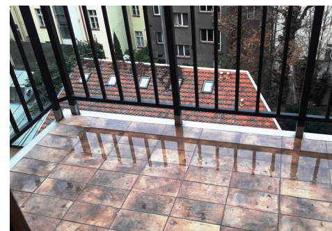
Obr. 5: Špatný sklon plochy balkonu, stojatá dešťová voda = problém.
