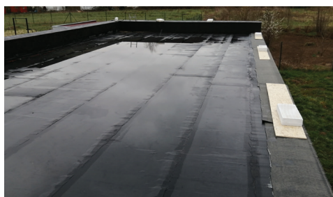
Obr. 1: Zadržovaná dešťová voda na ploché střeše = problém.
