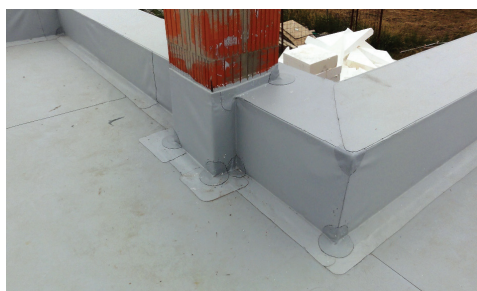
Obr. 2: Dodržení technologie montáže a všech předepsaných detailů ploché střechy zaručuje dlouhou životnost a ochranu pro ostatní stavební konstrukce.
