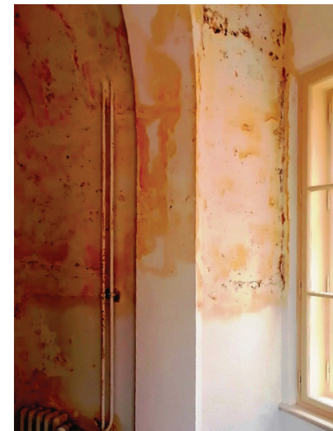
Obr. 7: Zatékání do prostor pod terasou – takové zatékání trápí někoho jiného než majitele terasy.
