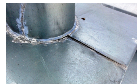
Obr. 8: Chybně a nekvalitně provedené klempířské prvky.
